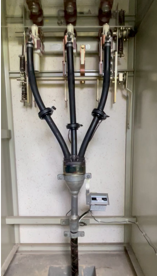
Einfach aufgeräumt: Die Lösungen von Horstmann bringen High-Tech und Ordnung in Mittelspannungsstationen.
